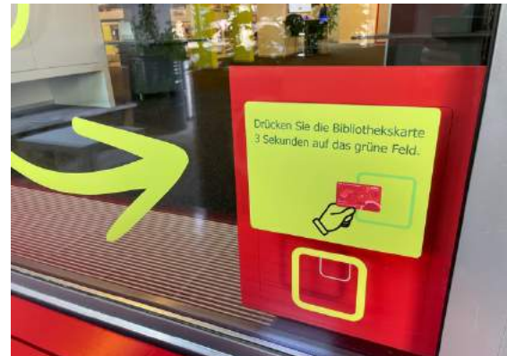
Das Zutrittsterminal neben der Eingangstüre
